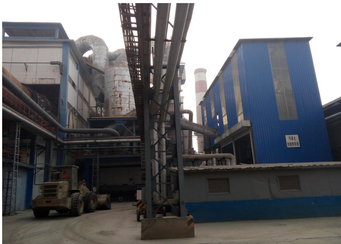
图 3.3-1 污染土壤热脱附设施
