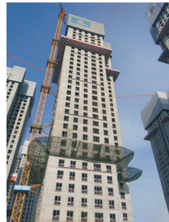
7#楼结构至36层，窗框安装至20层，本月底1-10层公区精装修开始施工
