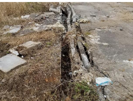
厂区雨水排沟
