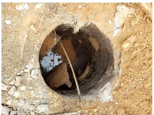
厂区清浄下水集水井
