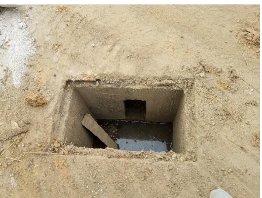
车间雨水集水井
