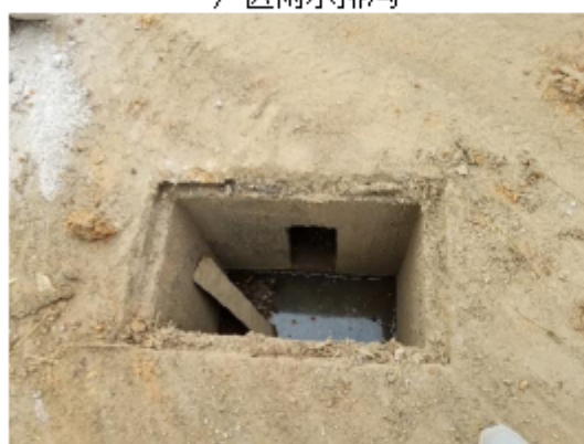
车间雨水集水井
