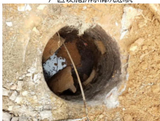
厂区清浄下水集水井
