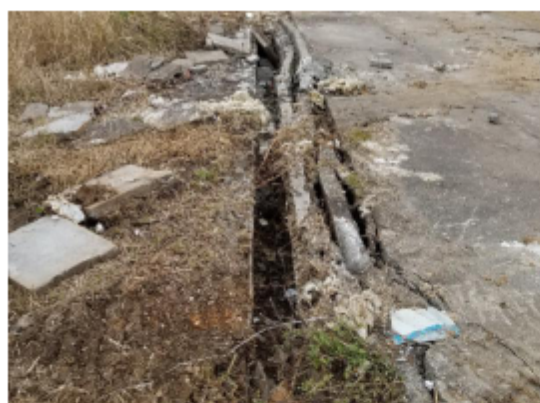
厂区雨水排沟
