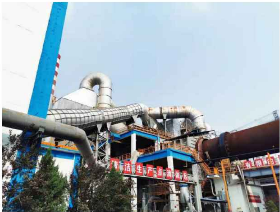
图 3.4.3 北水公司水泥窑焚烧及热脱附设施图
