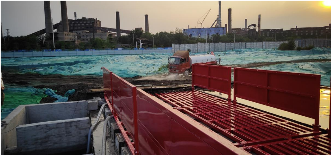
图 3.1-2 环保洗车循环系统照片
