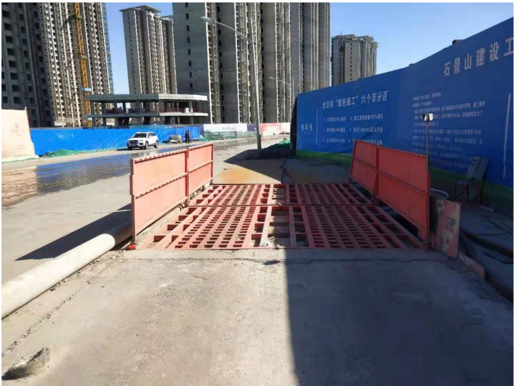
图 3.1-2 环保洗车循环系统照片
