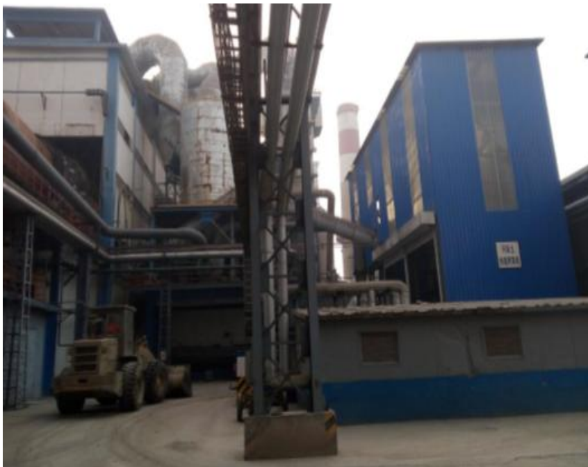
图 3.3-3 污染土壤热脱附设施
