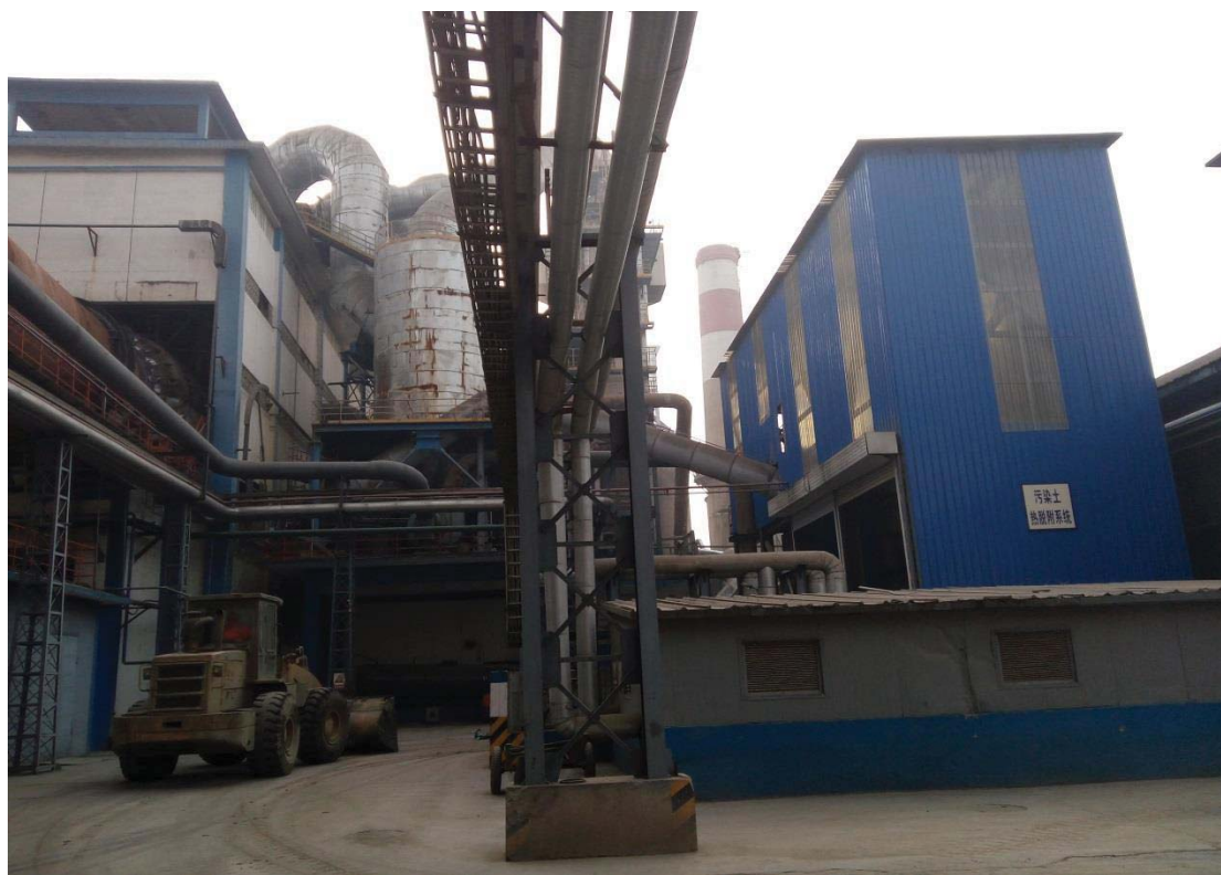
图 3.3-1 污染土壤热脱附设施
