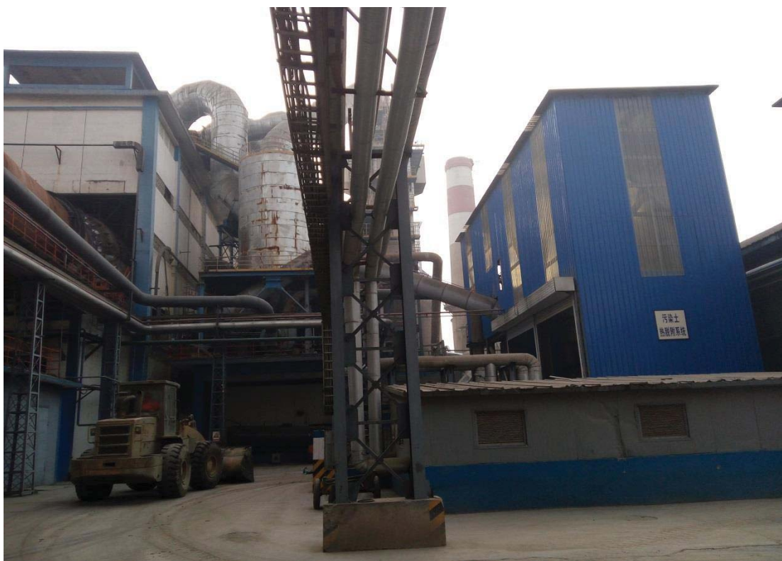
图 3.3-1 污染土壤热脱附设施
